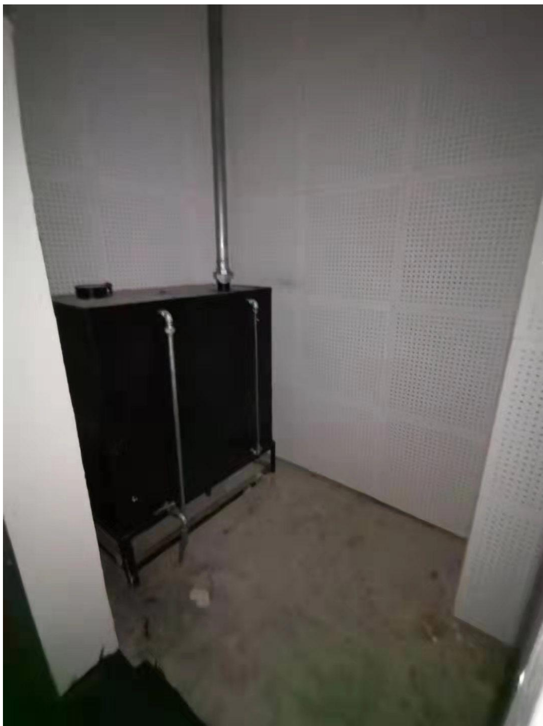
备用柴油发电机防渗措施
