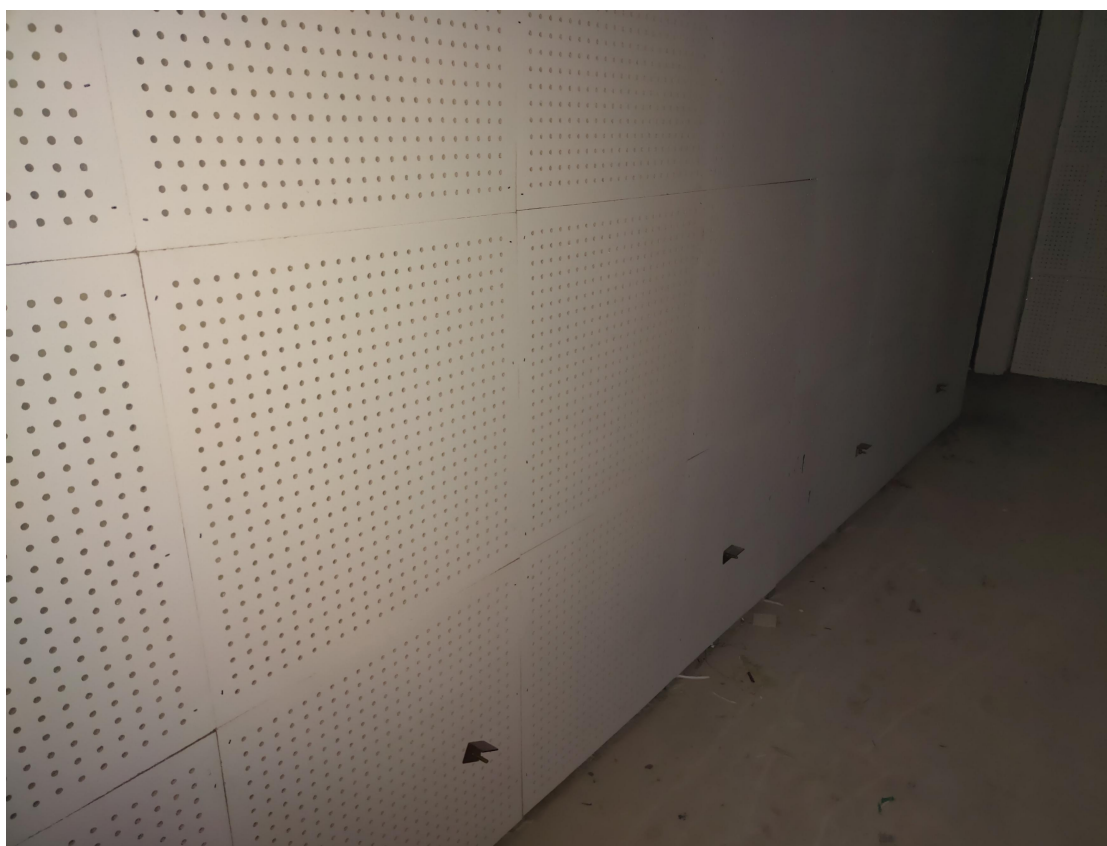
备用柴油发电机防噪措施
