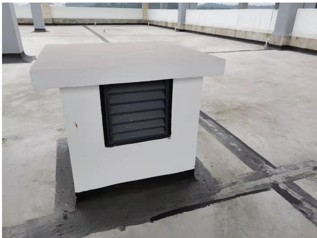
备用柴油发电机排气筒
