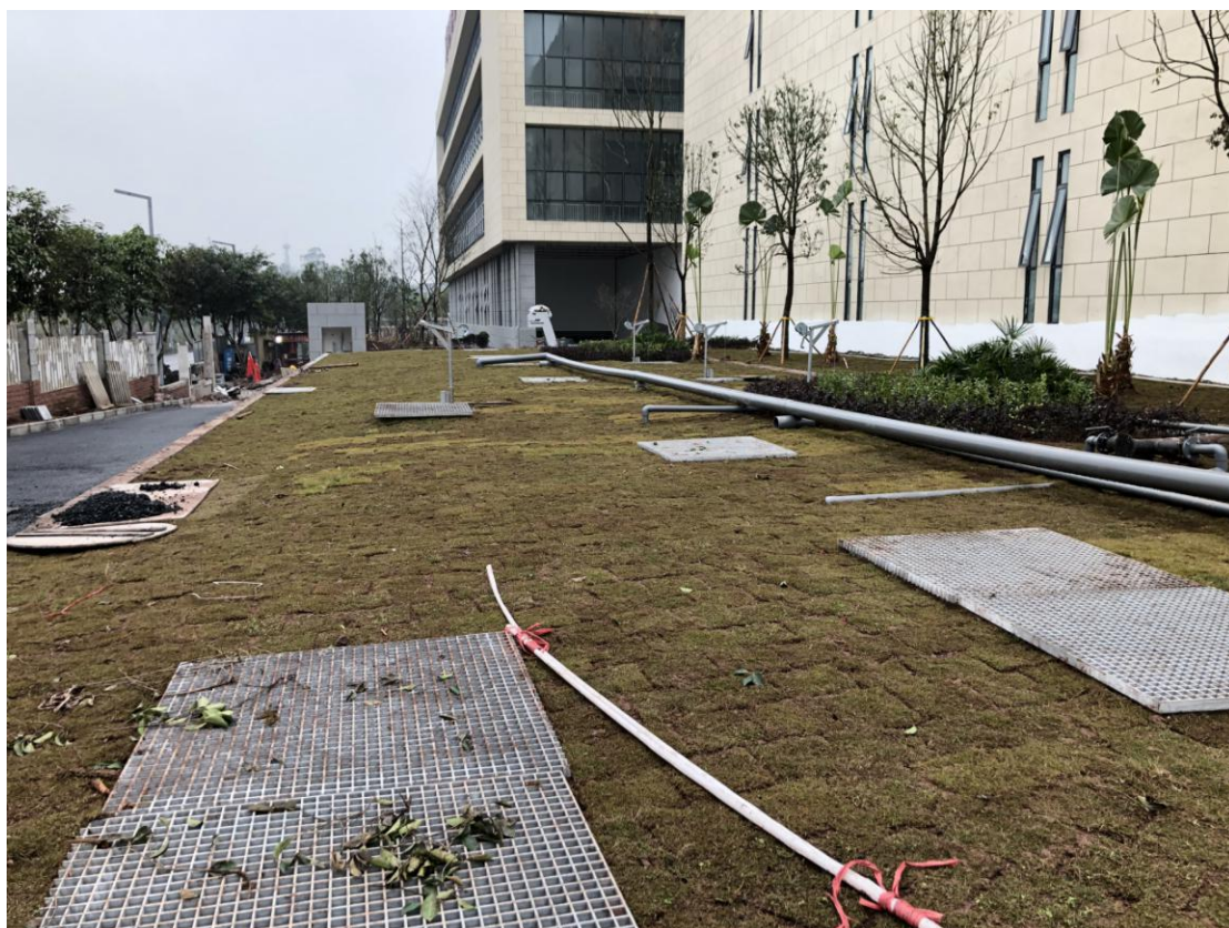
废水处理设施
